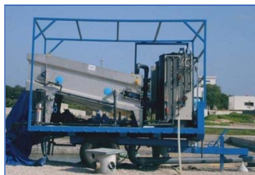
Мобильная станция уплотнения перед иловыми площадками
